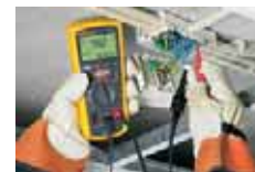
Comprobación del cableado en una pequeña caja de distribución: todo en el mismo sitio
